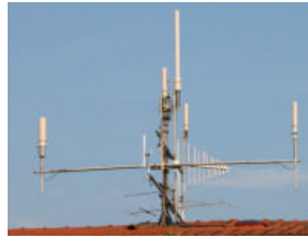
EH-Antennenmast bei I2MTW in Milano
